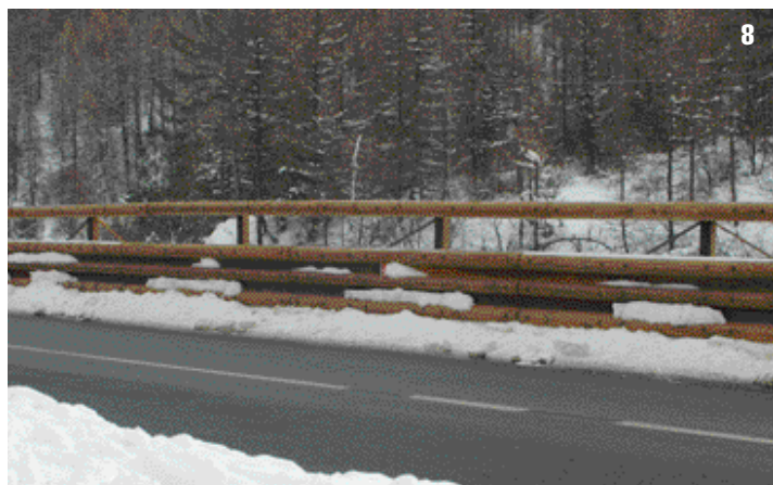
8 Ancora barriere in legno e acciaio SCT sulla SP 254
